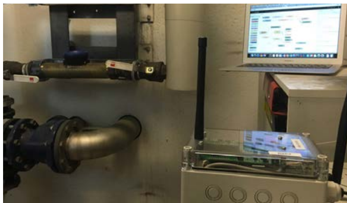
Etteplanin Espoon yksikkö on toteuttanut Helsingin Seudun Ympäristöpalvelulle (HSY) vesimittareiden etäluentajärjestelmän prototyypin, jossa siirtoon käytetään LoRa-verkkoa. Etteplan has delivered a prototype water meter remote reading system for HSY (Helsinki Region Environmental Services Authority). Meter data is transferred via a LoRa network.
